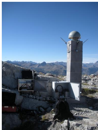
Alimentation solaire et électrique des pts GPS
